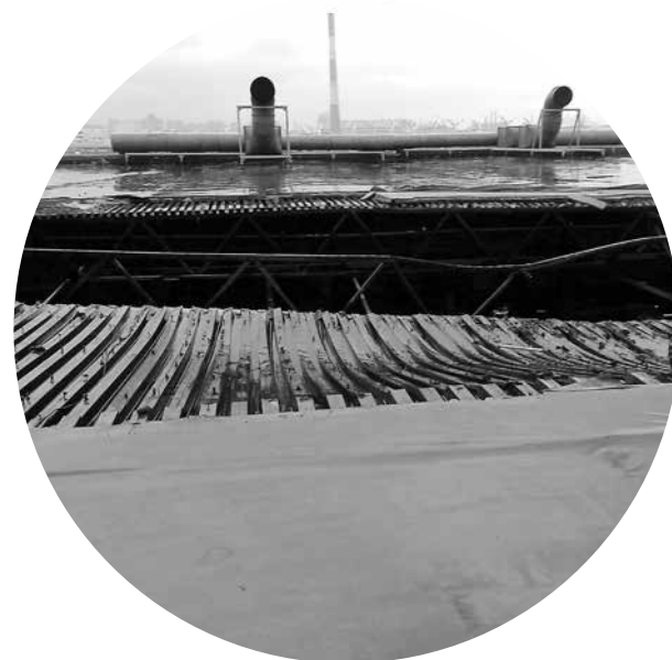
Обрушение конструкции кровли после пожара в торговом центре в Санкт-Петербурге
